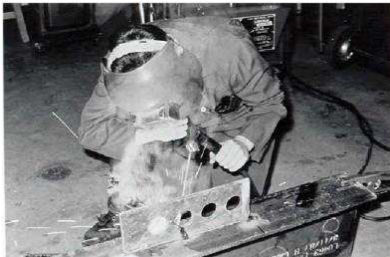
Figura 2-10. Soldagem de um conector Perfobond à mesa superior de um perfil metálico (OGUEJIOFOR, 1994).
