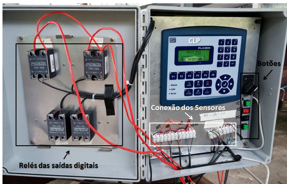
Figura 45 - Quadro de comando do sistema.
