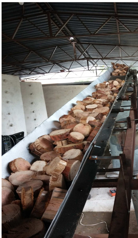
Figura 38 - Esteira transportadora com a calha carregada de biomassa.
