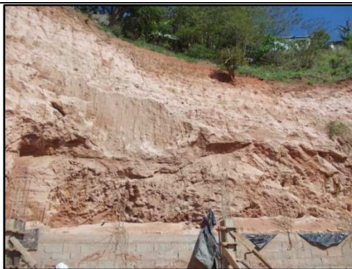
Ponto 75. (Corte de talude com declividade acima do limite de segurança.)
