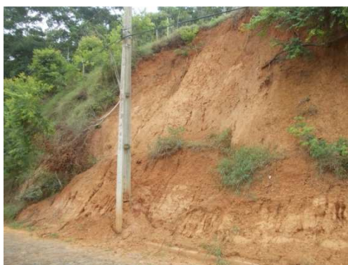
Ponto 82 (Talude de corte com altura e declividade excessiva e drenagem natural danificada).
