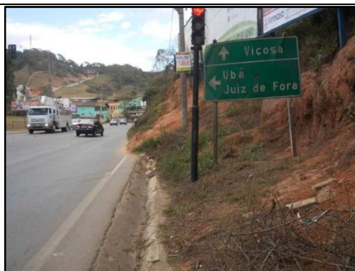
Ponto 10 (Talude com escorregamento superficial e drenagem da via obstruída).
