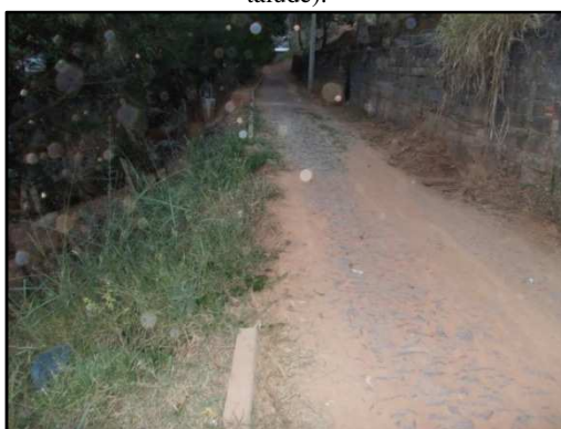
Ponto 15 (Drenagem da via no topo do talude danificada).
