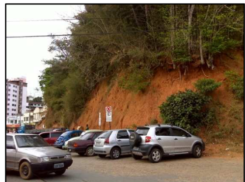
Ponto 99 (Talude com declividade excessiva).
