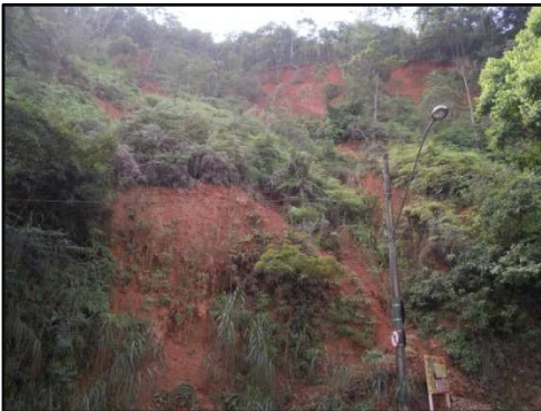
Ponto 07 (drenagem natural danificada)
