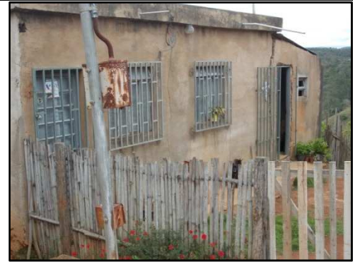
Ponto 49 (Trincas na moradia construída sobre aterro).
