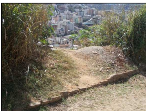
Ponto 12 (Lançamento de lixo e entulho no topo do talude).
