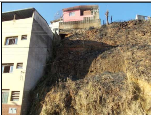
Ponto 24. (Talude com declividade excessivo).
