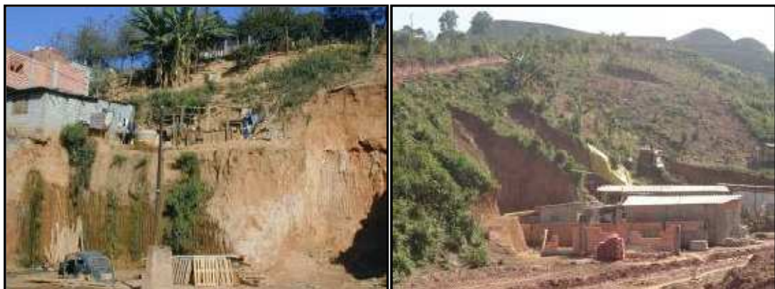
Figura 11: Cortes com declividade e altura excessiva.
