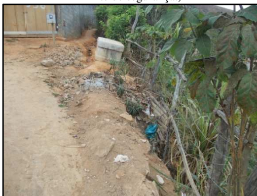
Ponto 17 (Lançamento de lixo e entulho no topo do talude).
