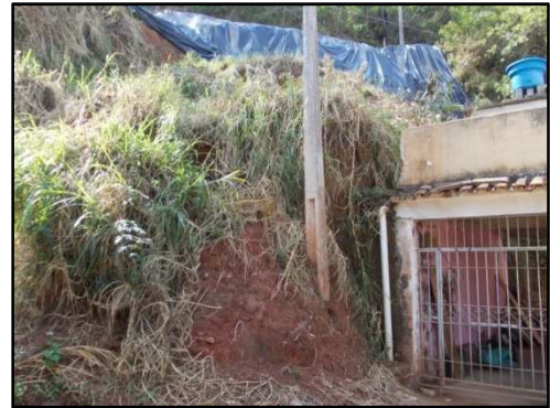
Ponto 53 (Rua no topo do talude sem pavimentação e drenagem)
