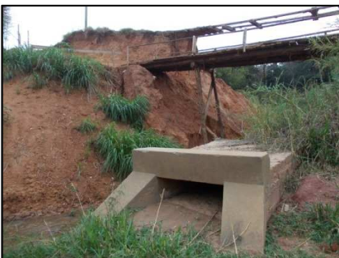
Ponto 33 (Galeria destruída solapamento de margens)
