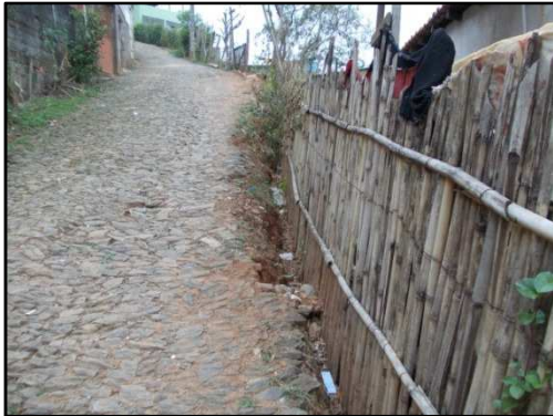
Foto 19: Ponto 31 (Drenagem da rua danificada).
