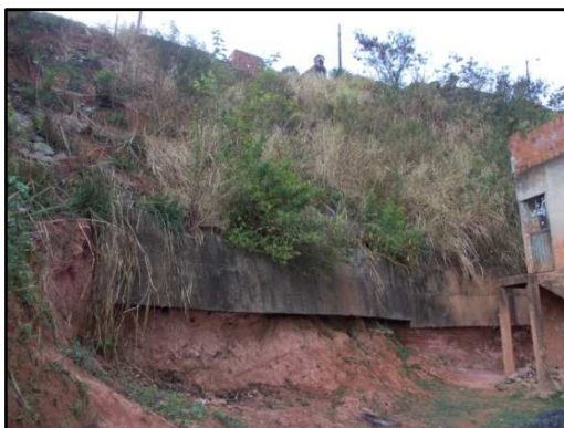
Ponto 18 (Descalçamento de muro de contenção)
