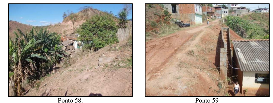
Figura 22: Ponto 58 e 59 (vias no topo do talude sem pavimentação e drenagem).
