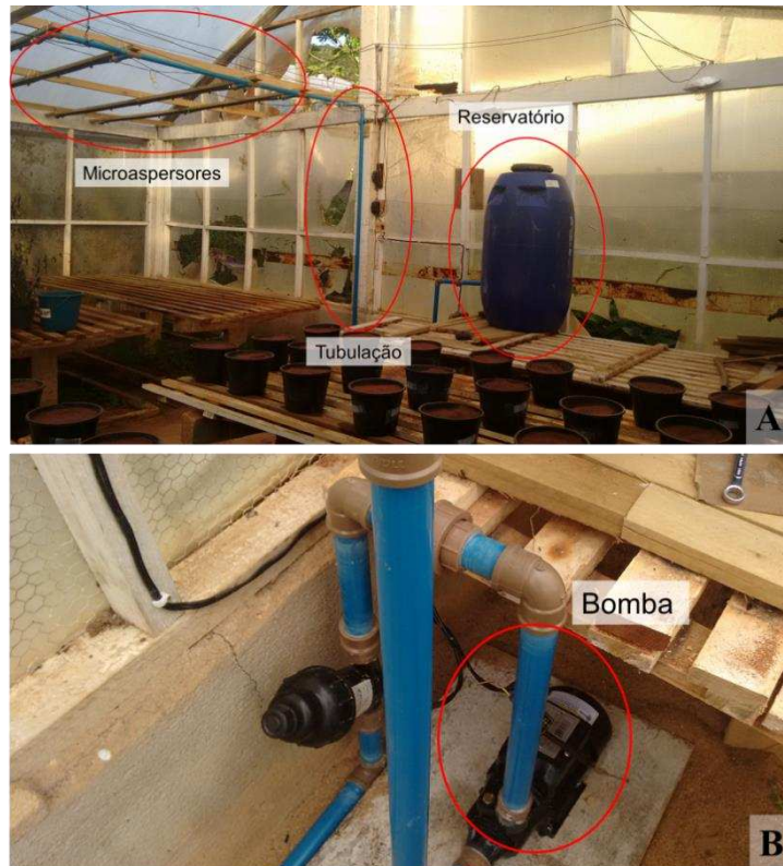
Figura 3 - Sistema de precipitação instalado sob as bancadas. Reservatório, tubulação e microsaspersores (A); bomba (B). Fotos: Daniel T. Pinheiro.
