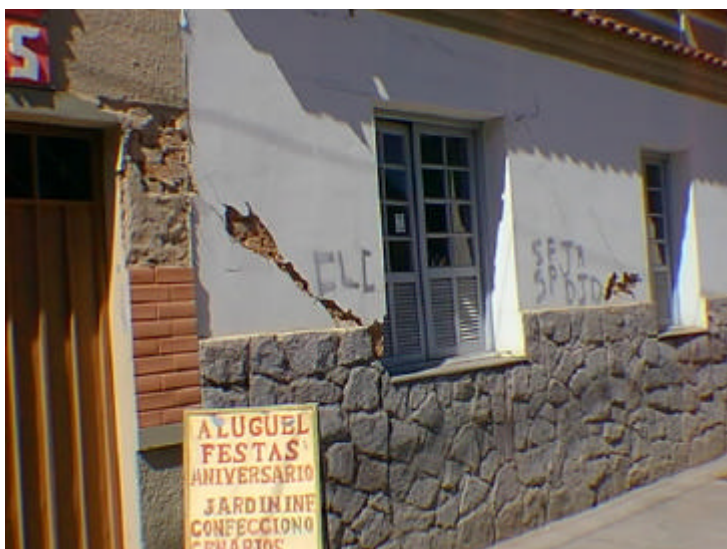
Foto 5.4: residência situada à Rua Cel. Tamarindo, já bastante danificada pela presença de trincas.
