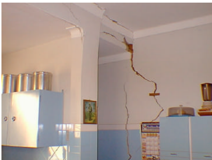
Foto 5.1: Trinca da Rua Prof. Eugênia se propagando pela parede de uma residência. Esta residência foi considerada como sendo de risco alto.
