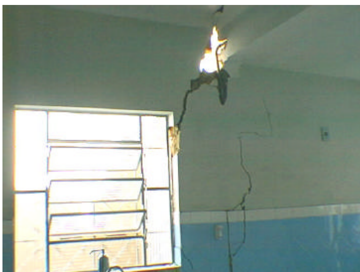
Foto 5.2: Efeito desta trinca na mesma residência. Nota-se a alvenaria bastante danificada e a trinca se propagando por uma viga, comprometendo a estrutura.
