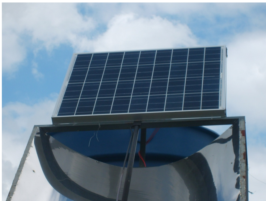
Figura 2.4: Painel fotovoltaico móvel preso ao coletor concentrador.
