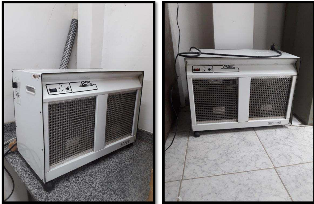
Figuras 41 e 42. Imagem dos desumidificadores, danificados. Fonte: acervo da autora.
