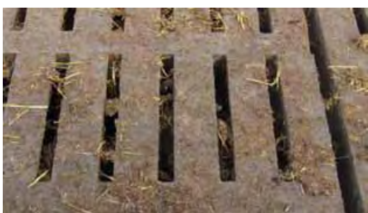
Figura 10. Piso de concreto com fendas sobre uma fossa (adaptado de Cortez & Cortez, 2006).
