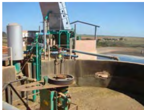
Figura 223 – Dispositivo de separação sólido / Líquido
