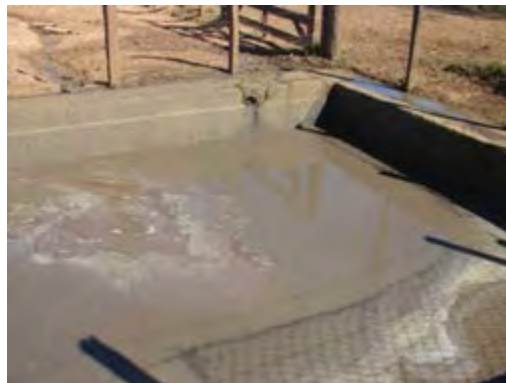
Figura 192 – Tanque de decantação de dejetos
