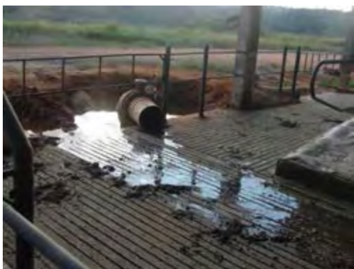
Figura 49– Tubo para limpeza (Flushing)
