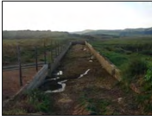
Figura 51 – Caixa de sedimentação de dejetos
