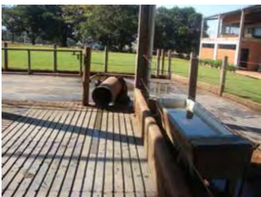
Figura 92 – Tubo para limpeza (Flushing)
