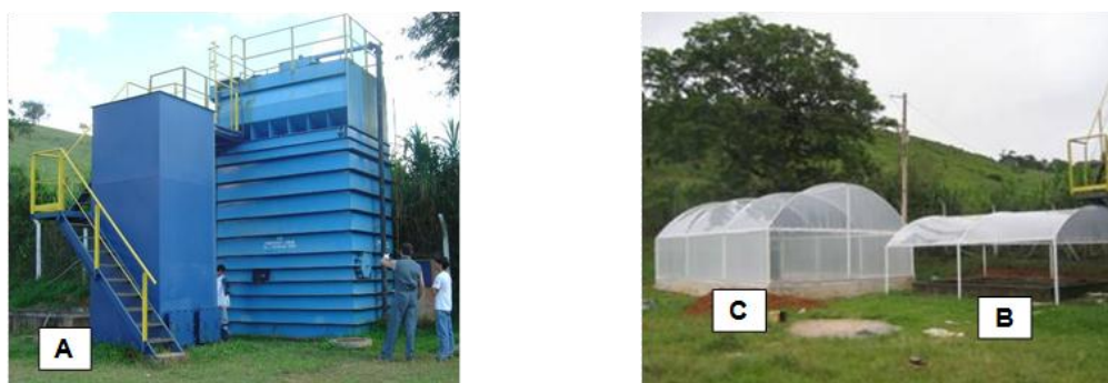
Figura 5 – Unidade Integrada de Tratamento e Utilização de Esgotos Sanitários da Violeira, Viçosa – MG: (A) Reator UASB e Biofiltro Aerado Submerso; (B) Leitões de Secagem; (C) Estufa de Secagem.
