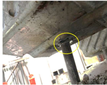
b) Rasgamento da fôrma de aço.
