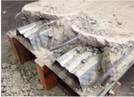
a) Esmagamento do concreto.
