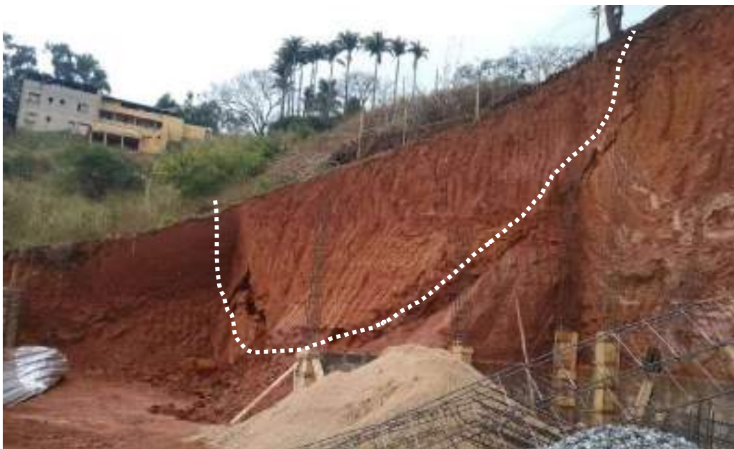
Figura 12 - Superfície de ruptura no talude na Rua Cid Gomes. Font: Defesa Civil de Ponte Nova-MG.
