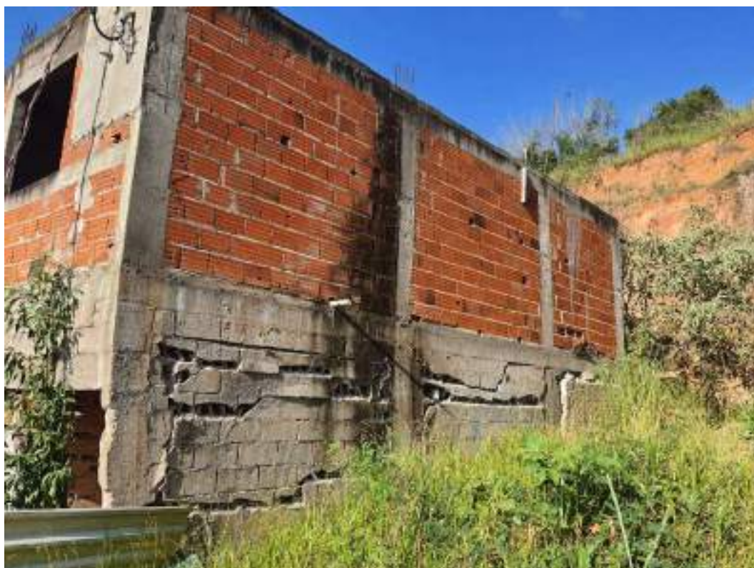
Figura 18 - Danos à edificação aos pés do talude na Rua João Afonso. Fonte: Defesa Civil de Ponte Nova-MG.
