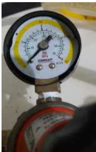
Figura 58 – Medidor de pressão disponível no sistema de aquecimento.
