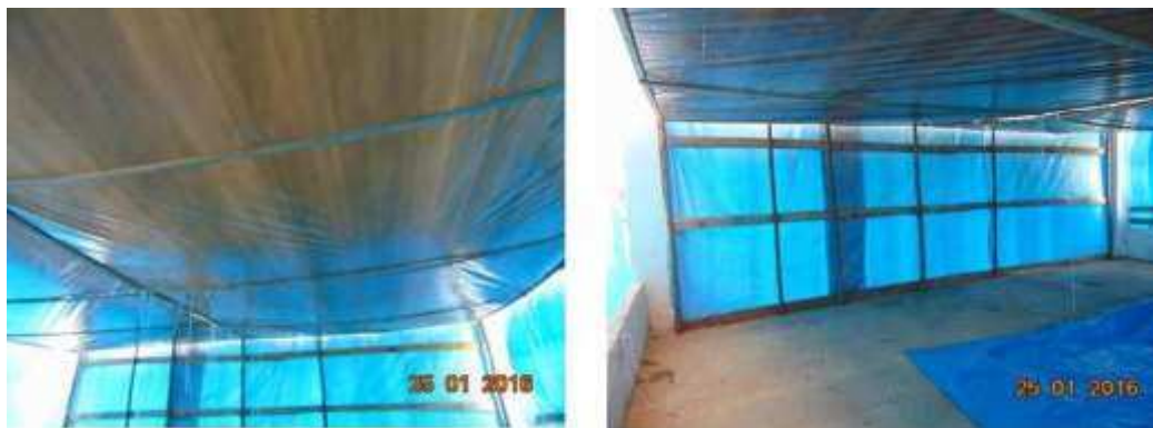
Figura 15 – Levantamento do forro pronto para delimitação do volume de ar a ser aquecido.
