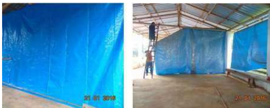
Figura 11 – Fechamento ao longo da largura de 8 m para delimitação da área de 96 m 2 .
