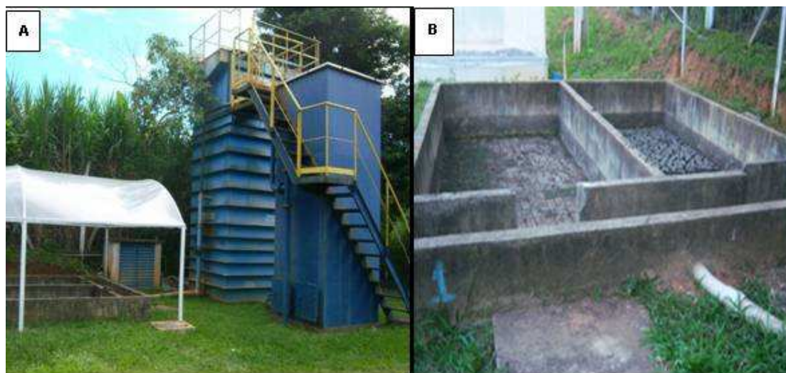
Figura 1 – ETE Violeira, Viçosa, MG: (A) Reator UASB + biofiltro e leitos de secagem cobertos; e (B) Detalhe dos leitos de secagem.
