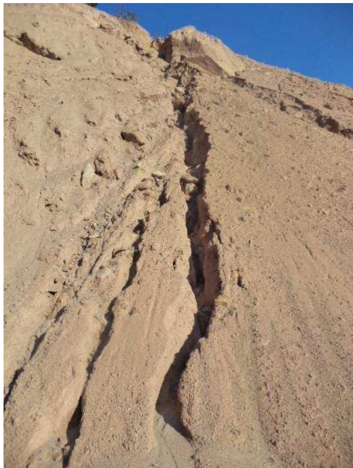
Figura 20. Processo erosivo no talude Nô da Silva Fonte: O autor, 2016.
