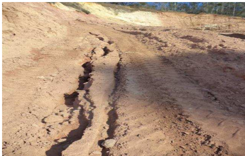
Figura 25. Processos erosivos nas vias de acesso a área de extração na Jazida Nô da Silva
