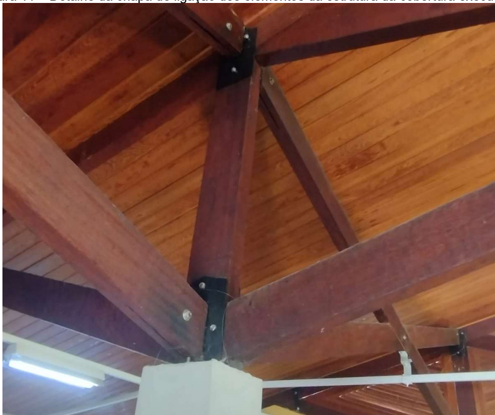
Figura 11 – Detalhe da chapa de ligação dos elementos da estrutura da cobertura executada.
