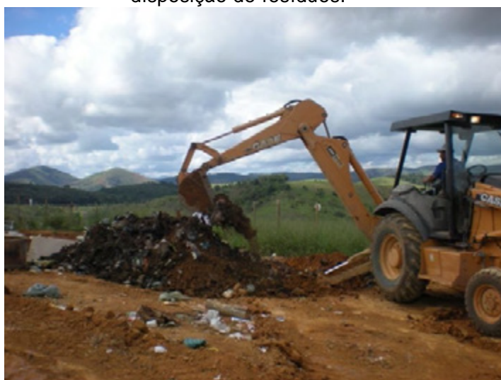
Figura 26 – Abertura de trincheira e remoção dos resíduos para coleta de amostras de solo sob a vala.
