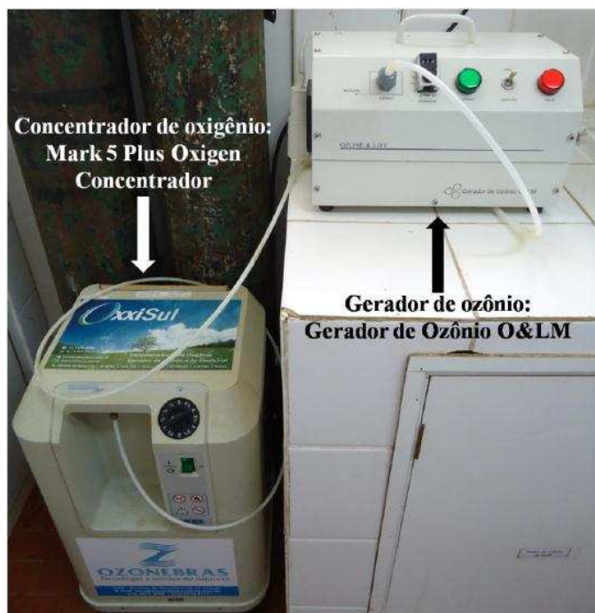
Figura 3 - Concentrador de oxigênio e gerador de ozônio.
