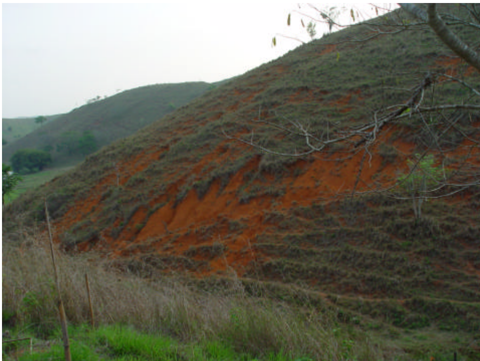
Figura 36. Aspecto dos processos erosivos de degradação das terras da unidade de paisagem de domínio dos Argissolos.
