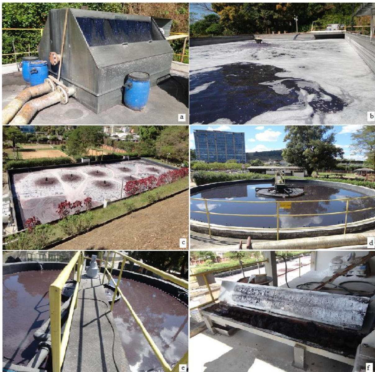
Figura 2.6 – Estação de tratamento de efluentes: (a) peneira; (b) tanque de equalização; (c) tanque de aeração; (d) decantador; (e) adensador de lodo; (f) centrífuga
