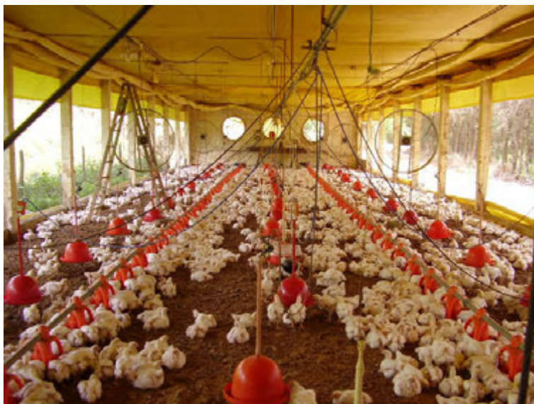
Figura 45. Vista interna do sistema de ventilação do galpão de frangos de corte em Barbacena, Minas Gerais
