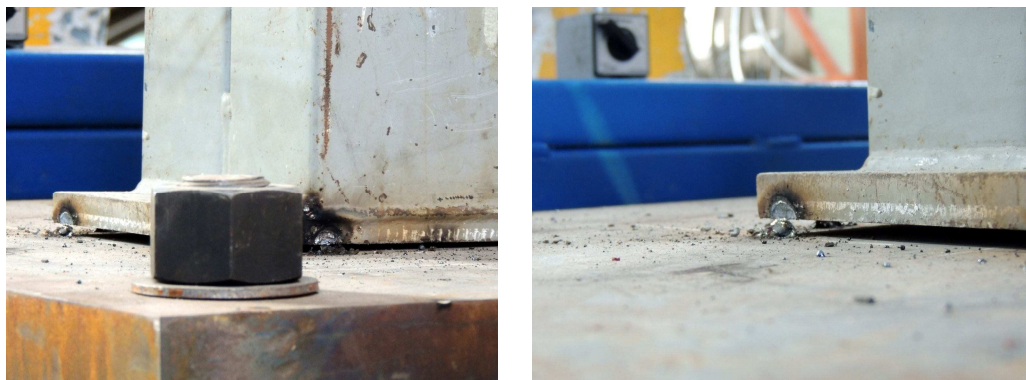
Figura 3.31 – Ruptura da solda do suporte do vínculo de garfo central da viga.
