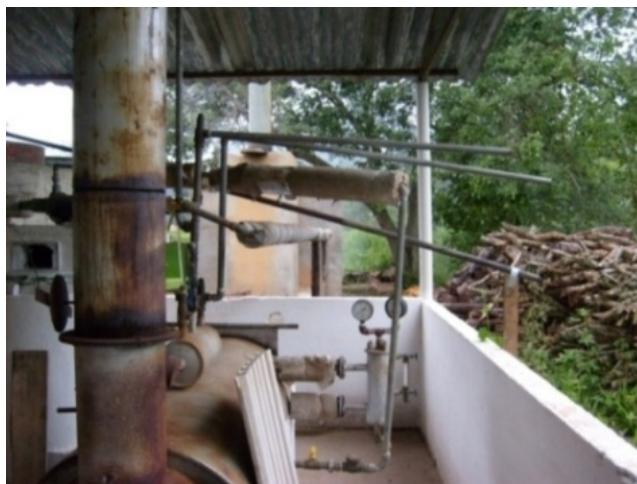
Figura 19 - Caldeira para geração e linha para distribuição do vapor.
