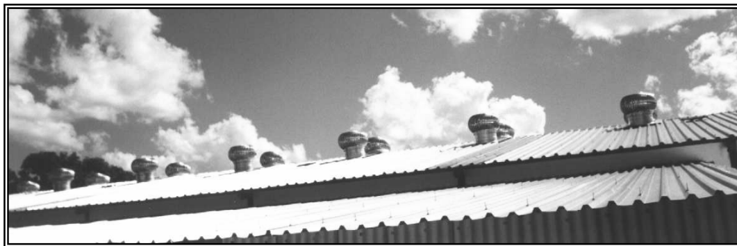
Figura 9 - Exaustores eólicos na cumeeira de uma instalação
