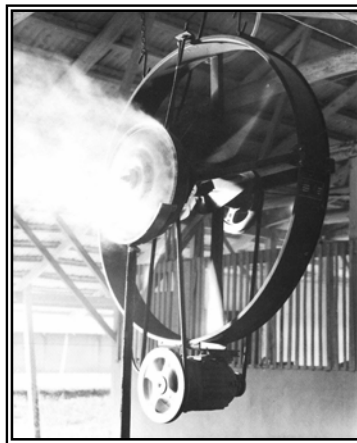
Figura 14 - Ventilador acoplado ao aspersor de água.
