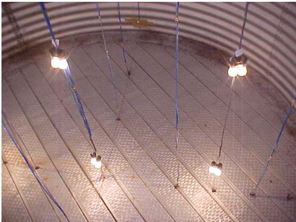
Figura 4A – Vista interna do silo, sistema de termometria e fontes de calor ligadas.
