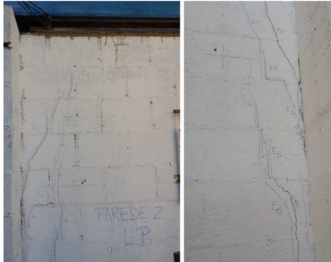
Figura 4-16 - Início das microfissuras e abertura de fissuras na alma / interseção aba (Painel 2)
