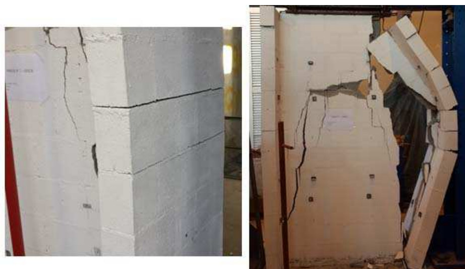
Figura 4-14 – Abertura de fissura na parte central da aba e alma (Painel 1)
