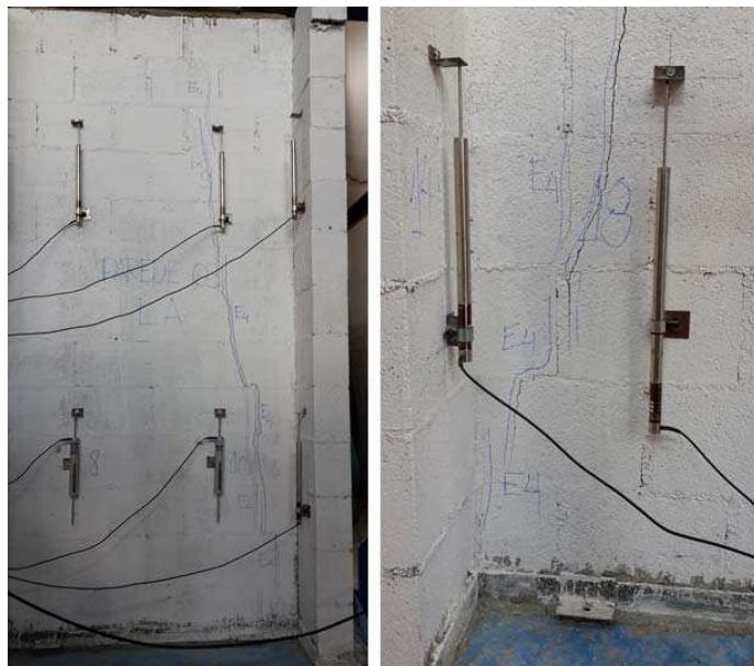
Figura 4-19 - Início das microfissuras e abertura de fissuras na alma / interseção aba (Painel 3)
