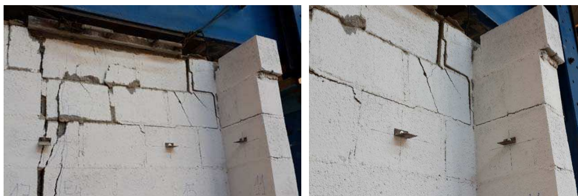
Figura 4-20 – Abertura de fissura (escalonada) na parte central da aba e alma (Painel 3)
