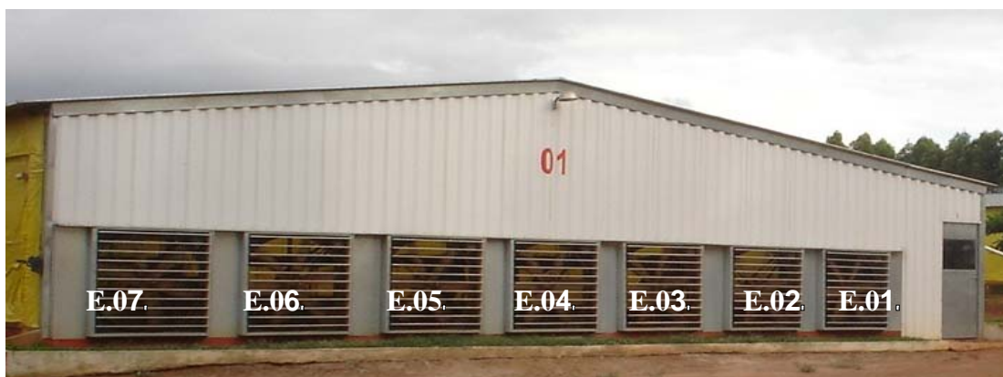
Figura 1. Vista geral do sistema de ventilação (Exaustores E01 a E07).
