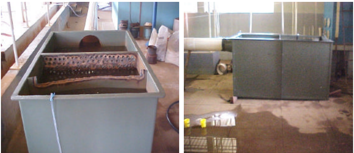
Figura 4 - Caixas estabilizadora (esquerda) e receptora (direita).
