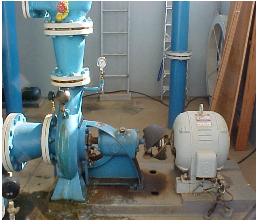
Figura 2 - Conjunto de recalque.
