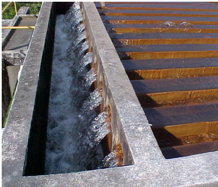
Figura 3 - Reservatório superior com calhas extravazadoras.
