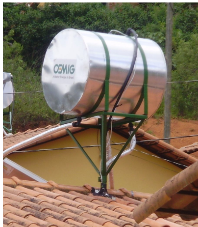
Figura 11 - Apoio para boiler tipo tripé, Nova Lima, 2010. Fonte: Autor
