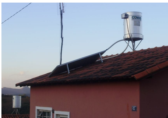
Figura 12 - Sistema de Aquecimento instalado, Itatiaiuçu, 2010. Fonte: autor.
