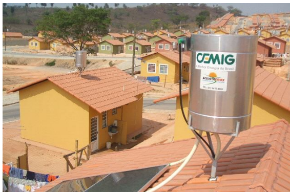
Figura 14 -Placa Solar - Casas COHAB. Fonte: Arquivo Aquecemax.
