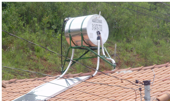
Figura 10 - Apoio para boiler tipo base biapoiada – Nova Lima, 2010.
