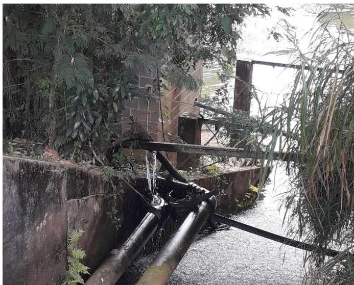
Figura 35: Vista do local onde foi identificada a cavidade erosiva.
