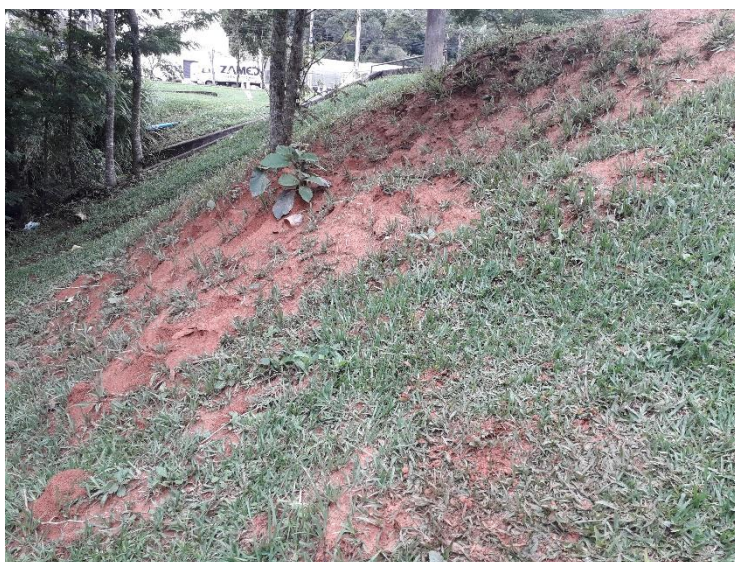
Figura 76: Formigueiro e árvores de grande porte identificados no talude de jusante da barragem.
