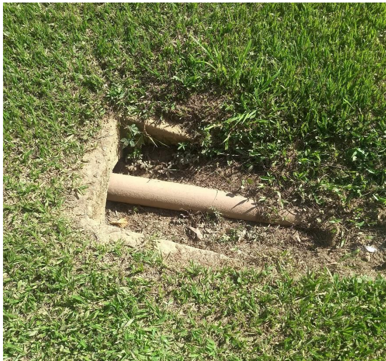
Figura 74: Registro da surgência da tubulação metálica.
