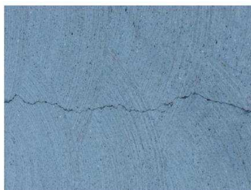
(b) Fissuras de restrição da laje
