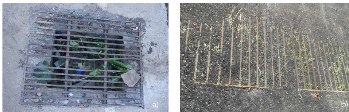
Figura 26 - Equipamentos de drenagem obstruídos - bairro São Cristóvão
