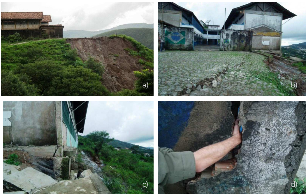
Figura 39 - Danos causados pelo risco geológico - Escola Padre Carmélio Augusto Teixeira
