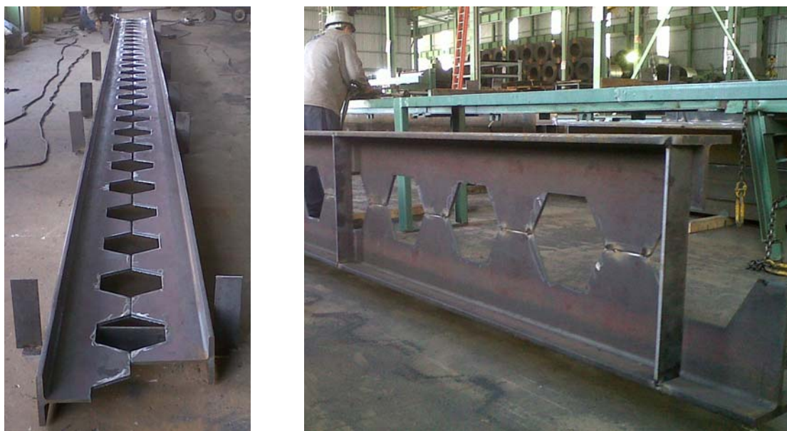
Figura 24 - Processo de fabricação de vigas alveolares em Vitória – ES (foto: TDB Projetos).
