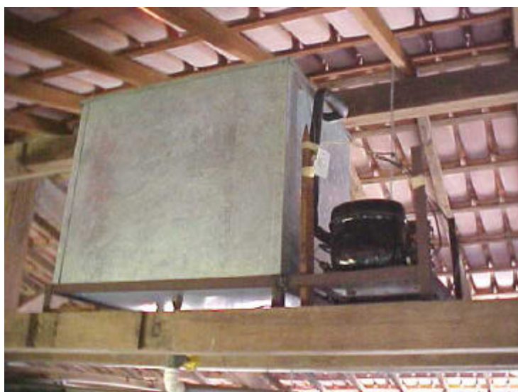
Figura 4 – Sistema de refrigeração da água montado na sala S 1 .
