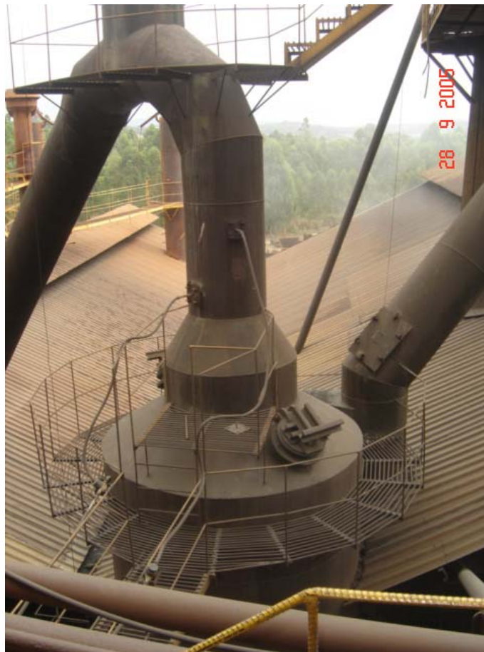
Figura 3. Detalhe de um coletor de pó gerado na saída de gases.
