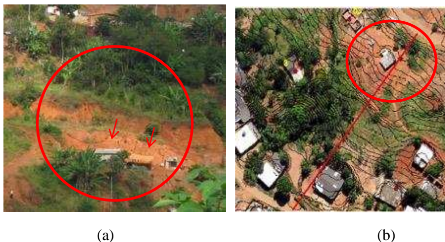
Figura 81. (a) Ponto de Análise - Bairro Córrego São Miguel, rua Orozimbo Gomes Figueiredo; (b) Seção com as curvas de nível de 1 em 1 metro, ponto de atingimento caso o talude venha a romper.
