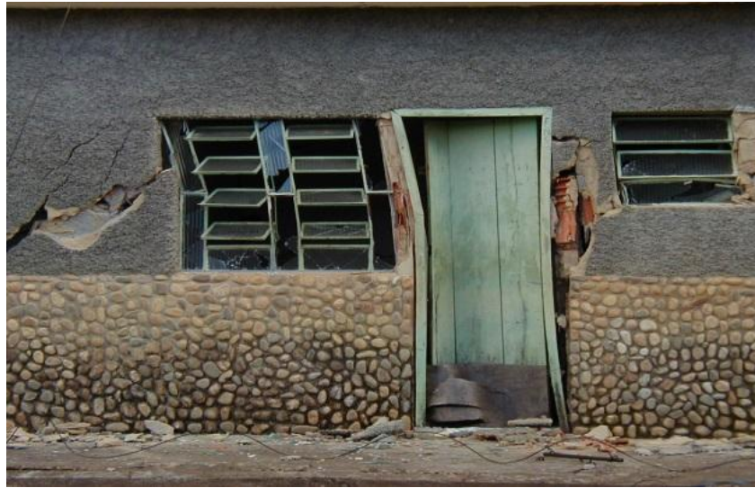
Figura 12 – Aspecto de casa do Bairro Panorama em 2005, após abalos e movimentação do solo.
