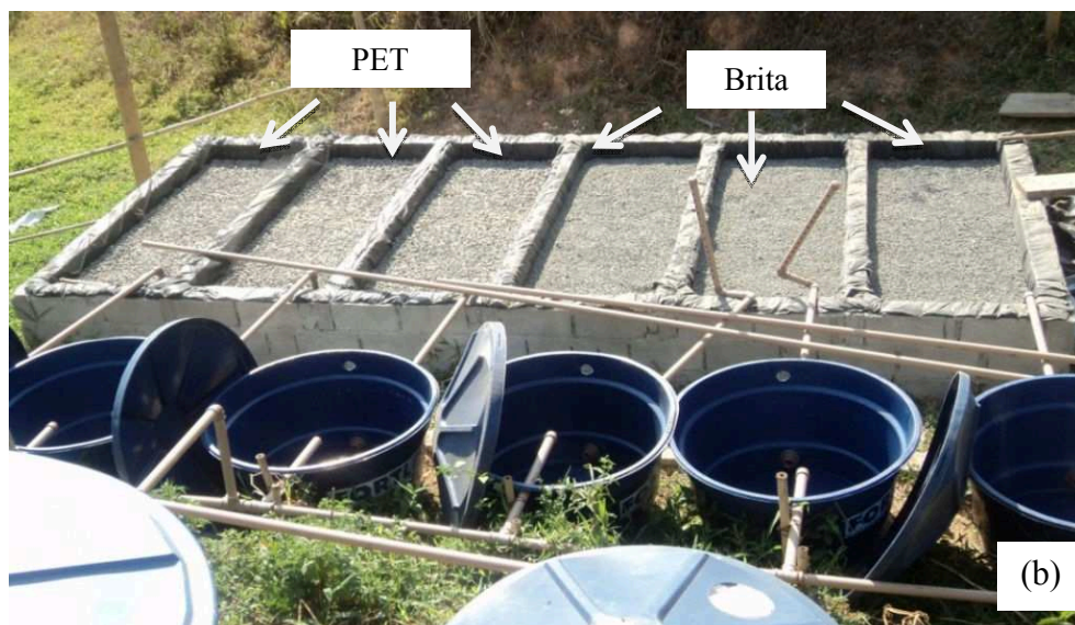
Figura 9: Visão geral dos seis SAC-EHSS, três preenchidos de garrafas PET e três preenchidos com brita # 0 (a) e após a colocação da camada de cobertura com brita gnáissica # 3(b).
