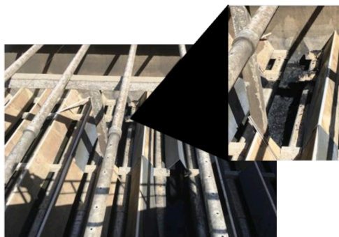
Figura 12 – Decantador da ETA Peniche, fora de operação; no destaque, camada de lodo remanescente no fundo do decantador
