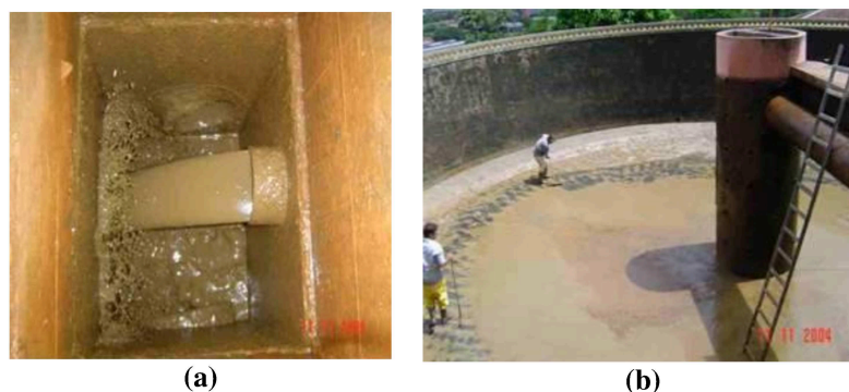
Figura 23 – Descarga de fundo (a) e operação de limpeza (b) do decantador da ETA UFV
