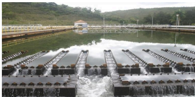
Figura 25 –Decantador da estação Rio das Velhas da Cia de Saneamento de Minas Gerais – COPASA MG
