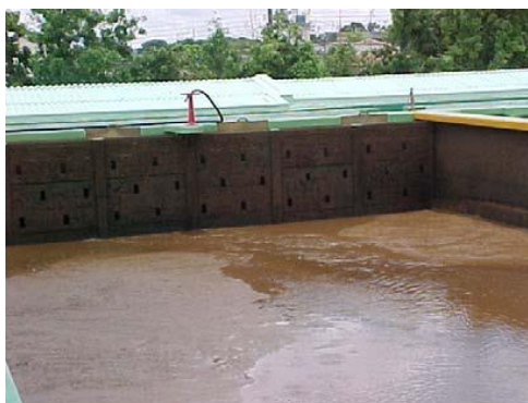
Figura 2 – Lodo acumulado em decantador convencional
