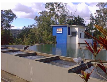
Figura 24 – Decantador circular (ao fundo) e floculador (a frente) da ETA I do SAAE – Viçosa-MG
