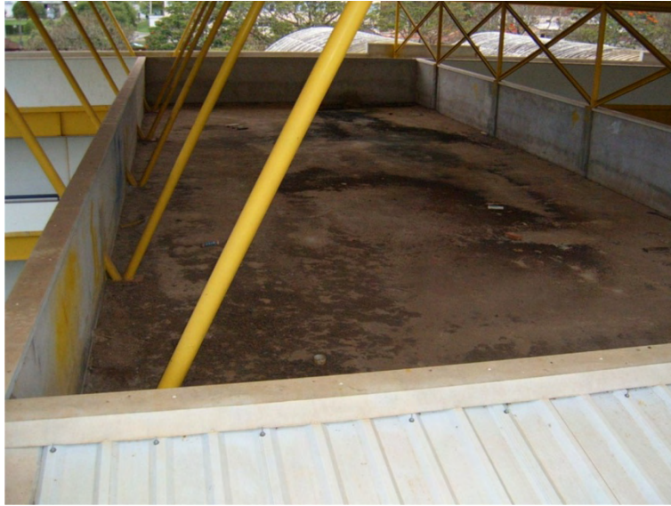
Figura 4.13 – Vestígios da retenção de água na laje abaixo da cobertura.
