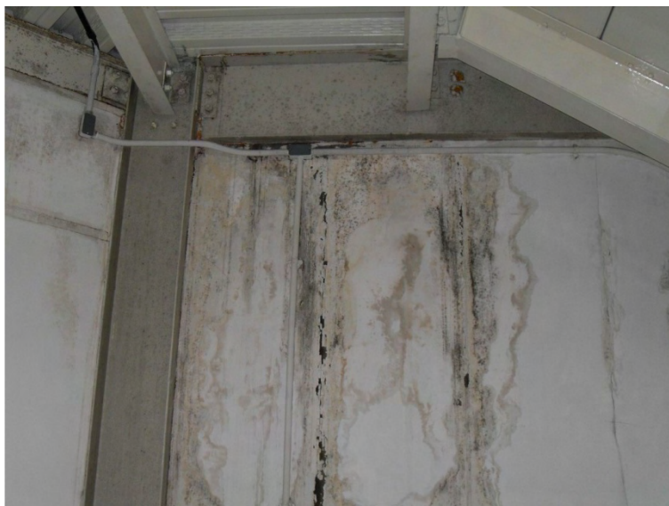
Figura 4.4 – Concentração de fungos e mofos em uma parede interna e a presença de umidade próxima ao sistema elétrico do edifício.
