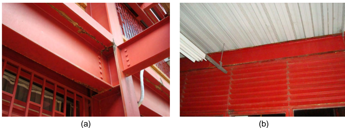
Figura 4.35 – Zonas de corrosão externa e interna próximas às paredes das fachadas.
