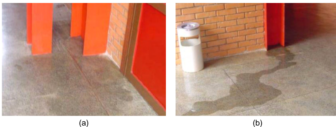
Figura 4.32 – Registros de águas de chuva no interior do edifício.
