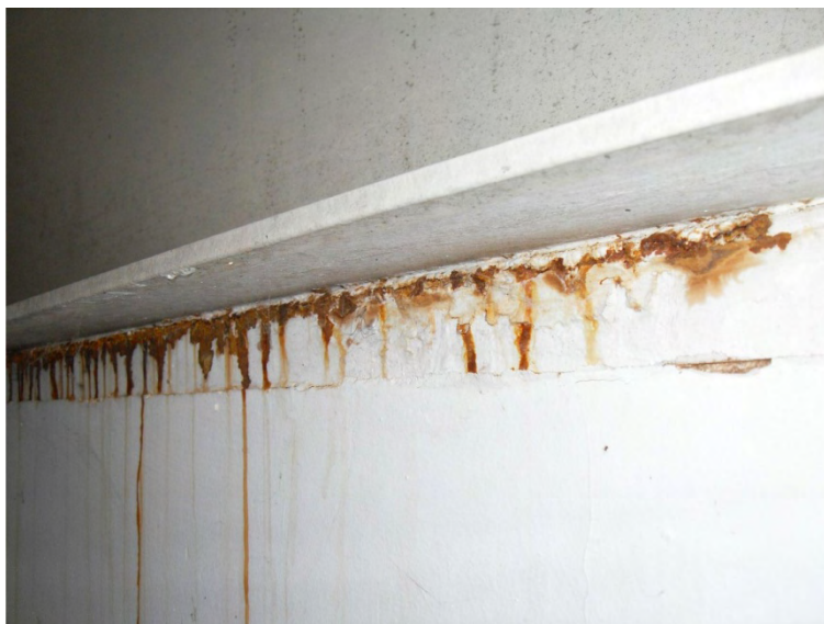
Figura 4.8 – Corrosão e escorrimento na parte interna de elementos metálicos.
