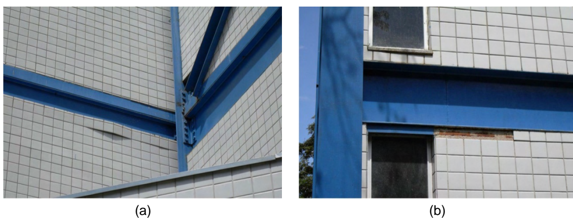
Figura 4.5 – Manifestações patológicas na fachada: (a) “estufamento” do revestimento cerâmico; (b) descolamento do revestimento cerâmico aplicado sobre os elementos que promovem a desvinculação do fechamento vertical.
