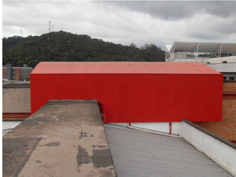
Figura 4.33 – Recente telhado instalado sobre parte do edifício para evitar a entrada de água através da cobertura.
