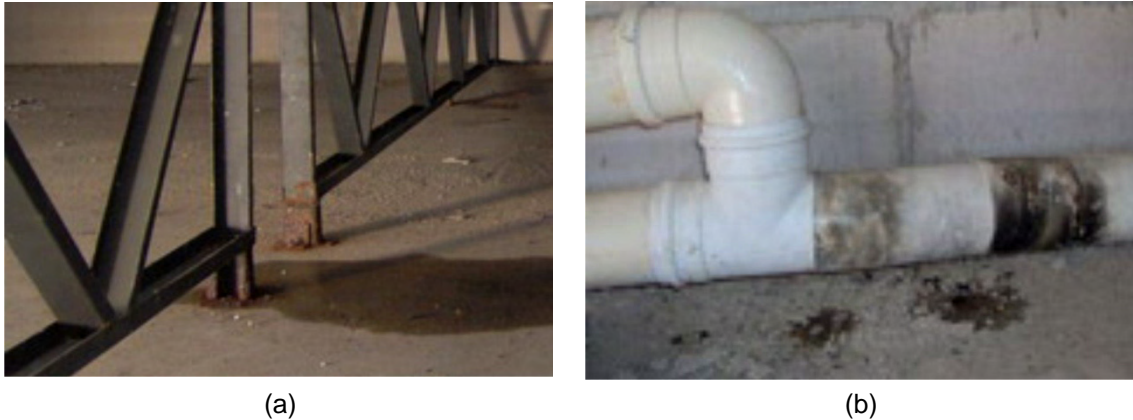
Figura 4.23 – Detalhes de execução da cobertura. (a) calços sob a treliça metálica; (b) vazamento em um coletor horizontal de águas pluviais.
