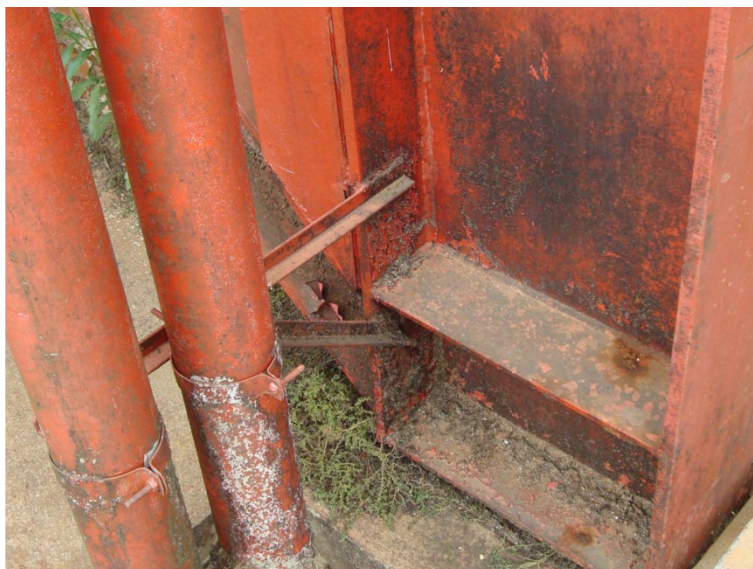
Figura 4.36 – Presença de fungos, mofos e corrosão na base de um pilar.
