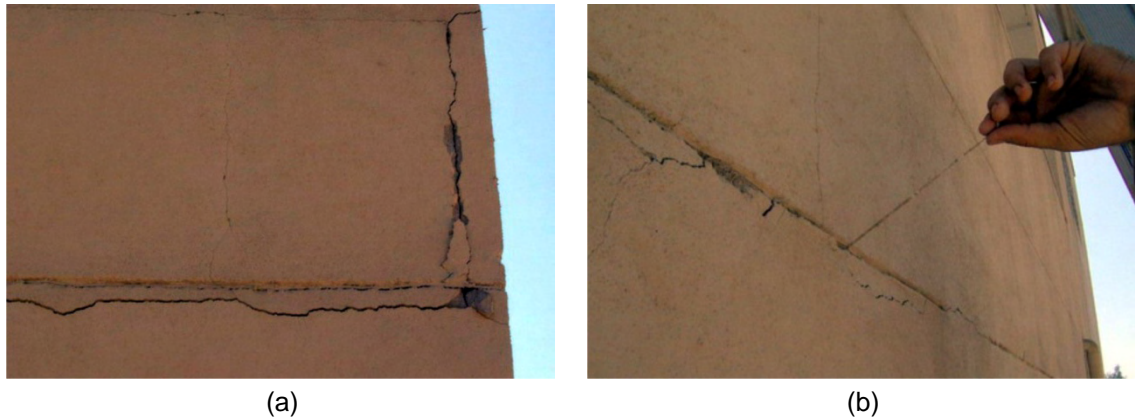
Figura 4.27 – Fissuras nas paredes externas do edifício. (a) Fissuração sistemática nas proximidades da junta de movimentação horizontal na região de colocação das placas de fibrocimento; (b) descolamento do silicone das juntas de movimentação horizontais.
