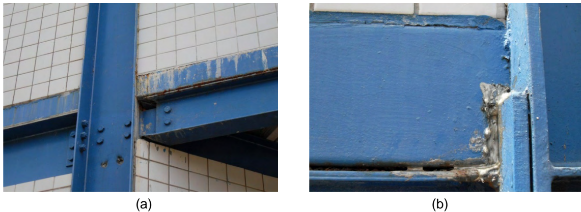
Figura 4.6 – Manifestações patológicas nos locais de aplicação do selante de poliuretano. (a) Corrosão e umidade nas chapas de arremate da laje mista; (b) detalhe de uma aplicação do selante de poliuretano.
