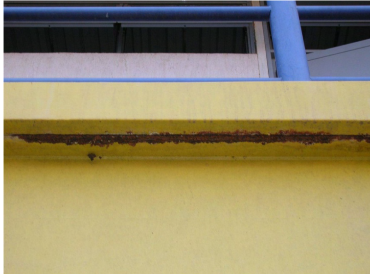
Figura 4.16 – Zona de corrosão entre a chapa de arremate da laje mista e a mesa superior da viga de aço.
