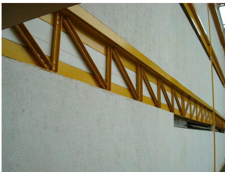
Figura 4.19 – Flecha observada nas treliças.
