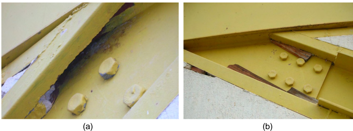
Figura 4.18 – Manifestações patológicas nos contraventamentos. (a) Desprendimento de elementos de vedação; (b) detalhes de improvisos com madeira.
