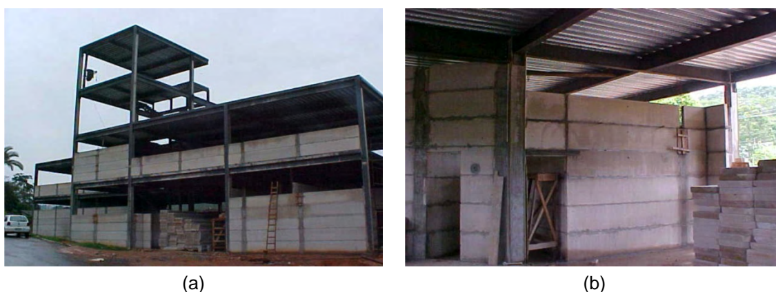
Figura 4.22 – Imagens da construção do Edifício da COPEVE. (a) Vista externa; (b) vista interna.
