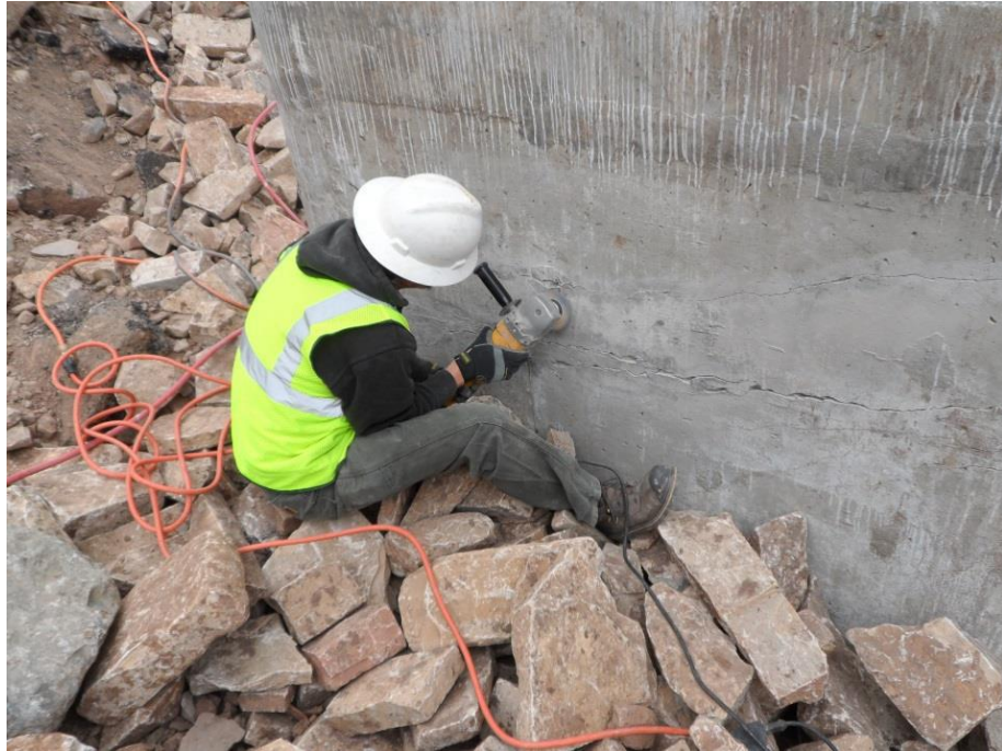
Figura 2.25 - Limpeza da superfície de uma fissura usando uma pequena lixadeira.
