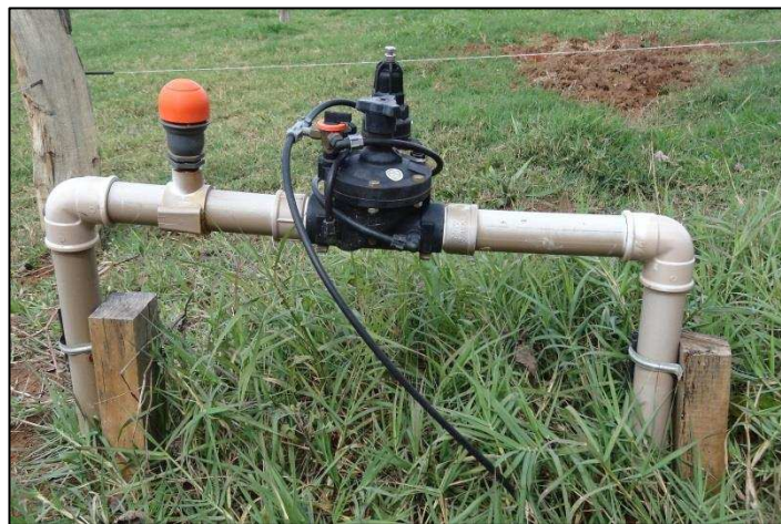
Figura 16 – Válvula automática utilizada no experimento.
