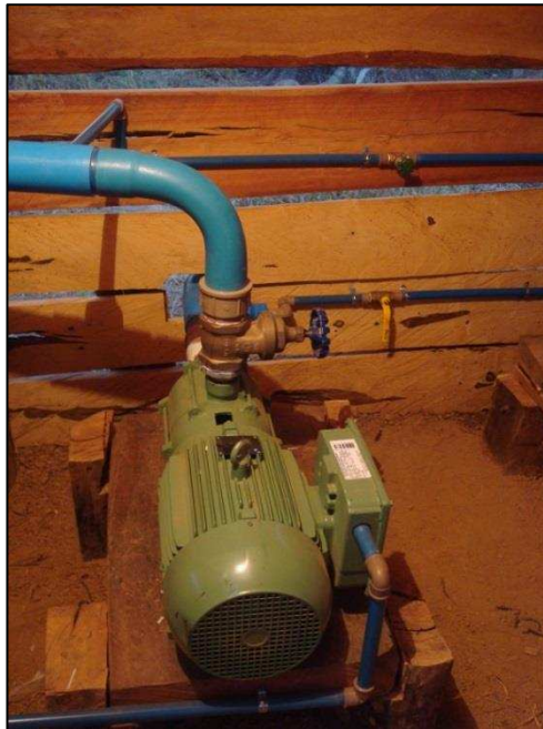
Figura 15 – Motobomba utilizada na pressurização do experimento.
