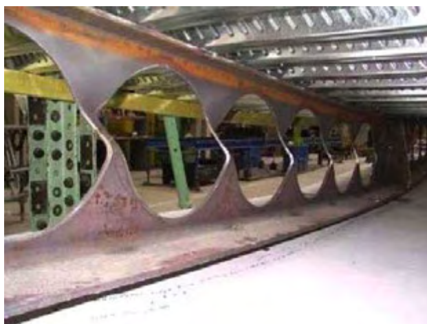
Figura 68 – Aspecto da flambagem do montante de alma numa viga alveolar mista (foto: ArcelorMittal).
