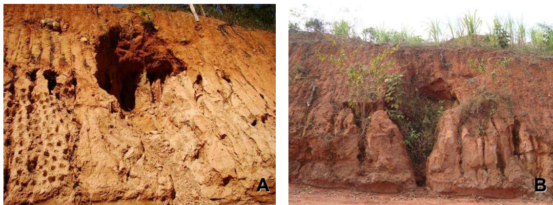
Figura 20 - Evolução do desprendimento de solo observado no ponto 6, em 2009 (A) e em 2012 (B).
