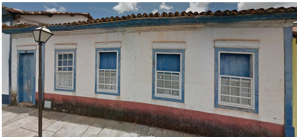
Figura 13 - Casa abandonada na Rua Direita.
