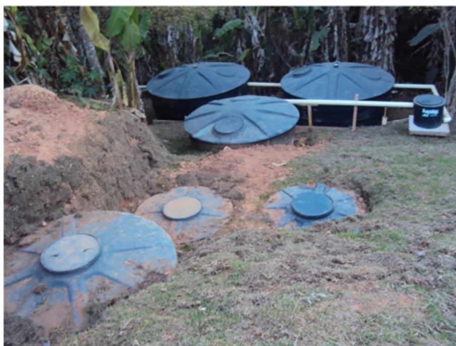
Figura 13 – Estação de tratamento de esgoto Fonte: Instituto de Planejamento Municipal de Viçosa
