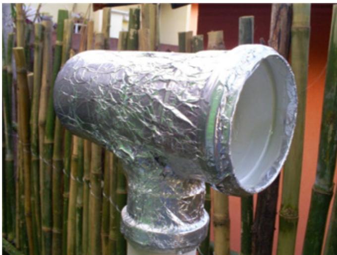
Figura 22 – Abrigo externo dos equipamentos data logger
