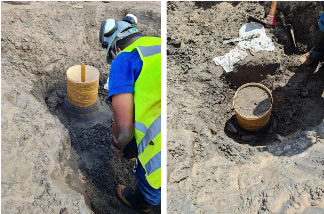
Figura 4.3 – (a) Continuidade da cravação estática de tubo de PVC; (b) Finalização da cravação estática de tubo de PVC.
