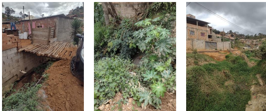
Figura 15 - Escoamentos sanitários à céu aberto.
