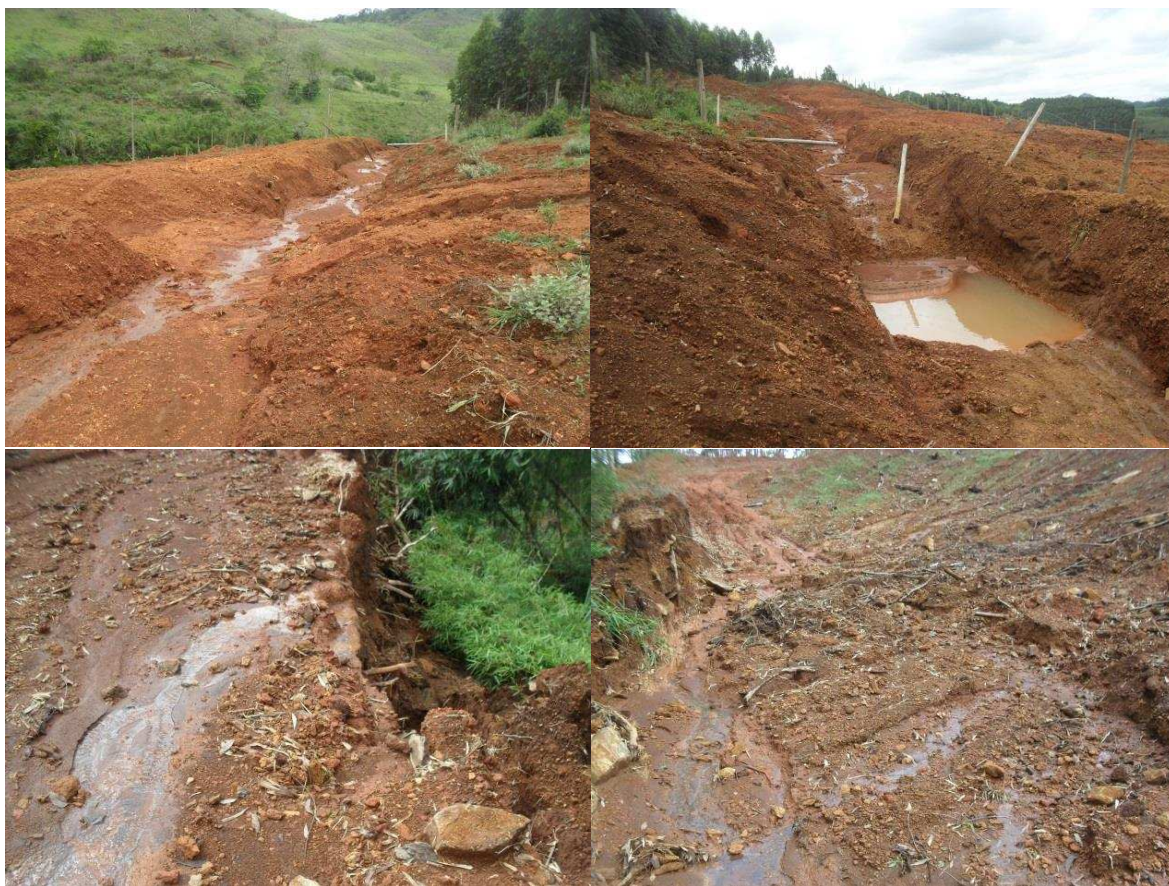
Figura 39 - Afloramento de água em áreas em reabilitação. São Sebastião da Vargem Alegre-MG,2017.
