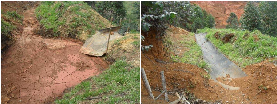
Figura 18 - Uso de correias transportadoras no controle de processos erosivos em áreas de exploração de bauxita. Rosário da Limeira-MG, 2017.
