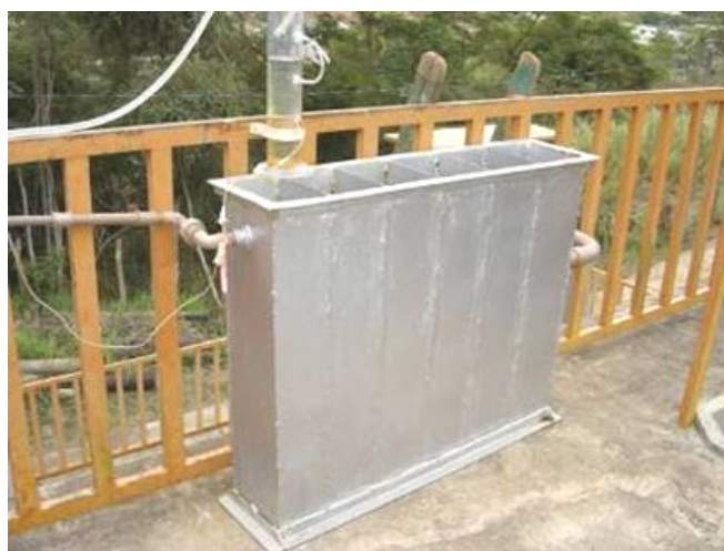
Figura II.3 – Vista lateral do floculador da ETA Piloto.
