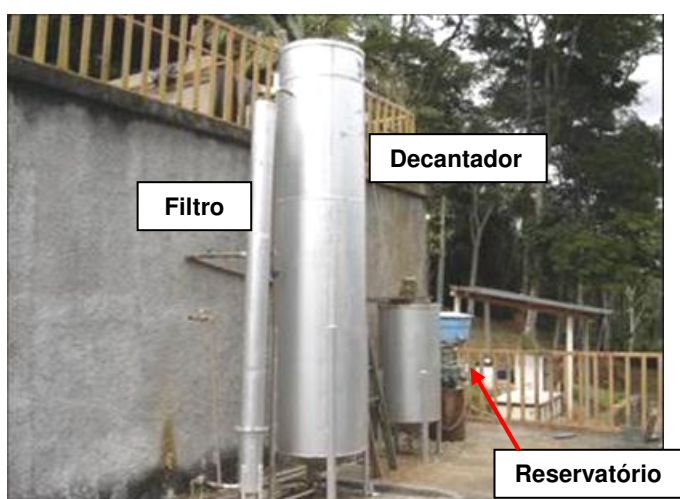
Figura II.4 – Vista parcial da ETA piloto, decantador, filtro e reservatório de inoculação de cianobactérias.
