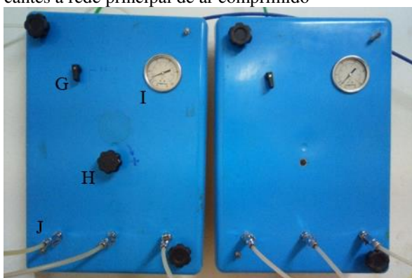
FIGURA 23 – Vista frontal dos painéis intercomunicantes à rede principal de ar comprimido
